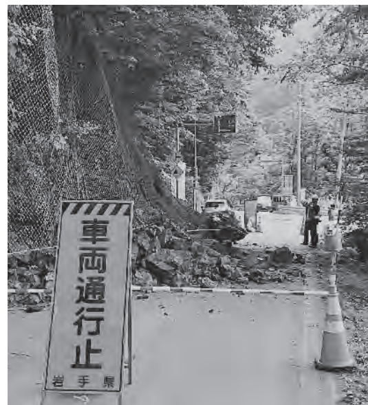
崩落事故発生時の状況
