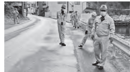
白線の塗り直し必要箇所（小川）
