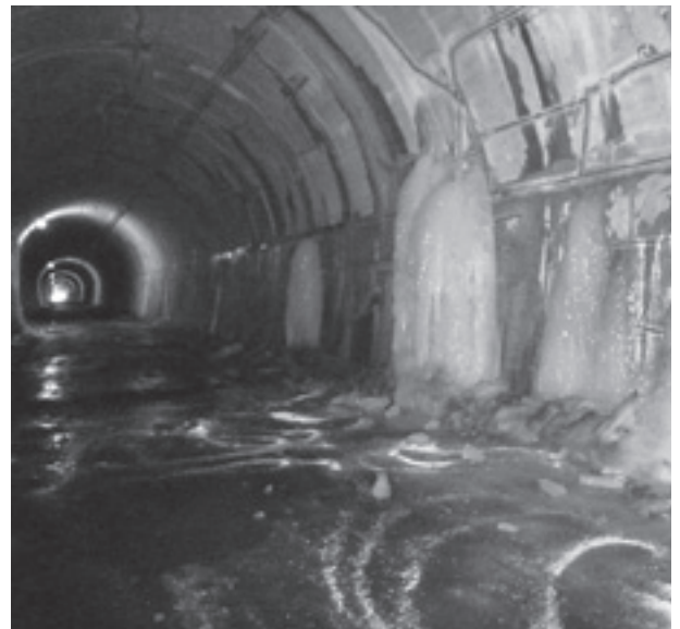
冬季間漏水等で凍結する奥岩泉トンネル
