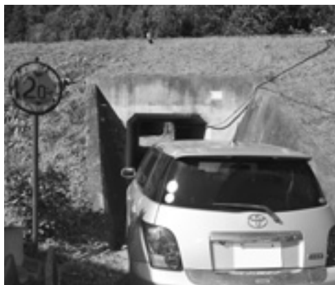
車の通行が困難な状態の鉄道橋(二升石地区)
