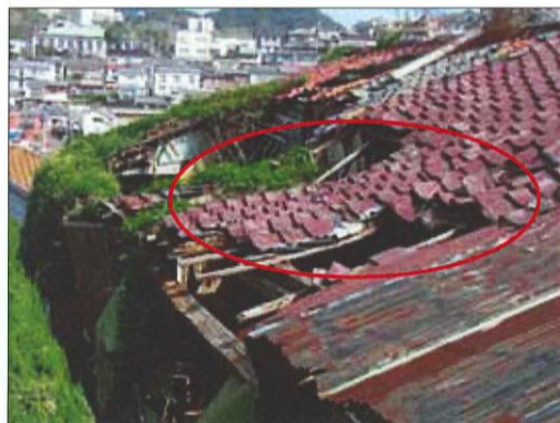
柱、はりの破損や変形が著しく崩壊の危険がある例
