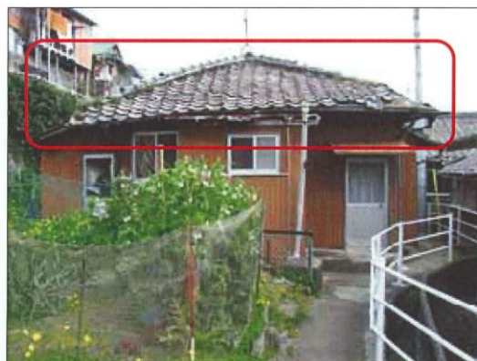
屋根に不陸がある例
