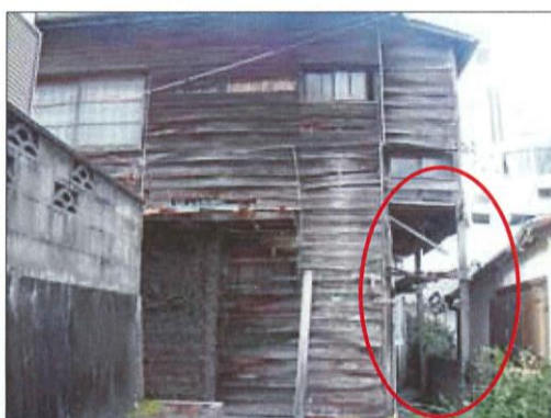
柱の数箇所に破損がある例
