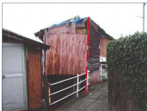
一部の柱が傾斜している例
