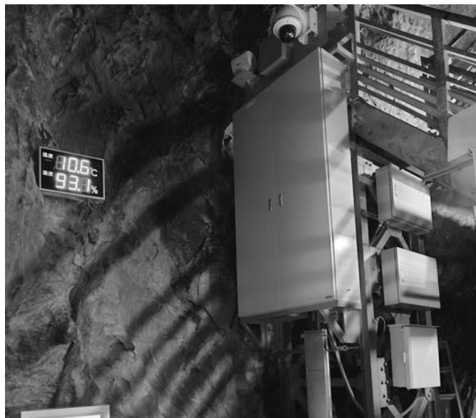
移設される分電盤
